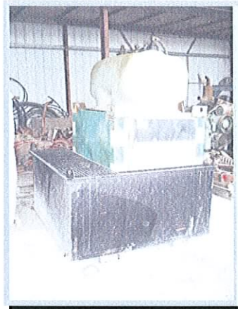
Citerne à fioul avec bac de rétention
