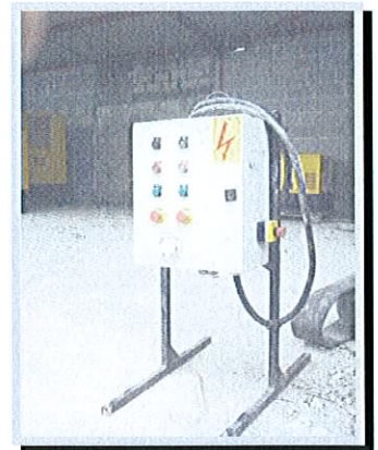
Armoire électrique de chantier
